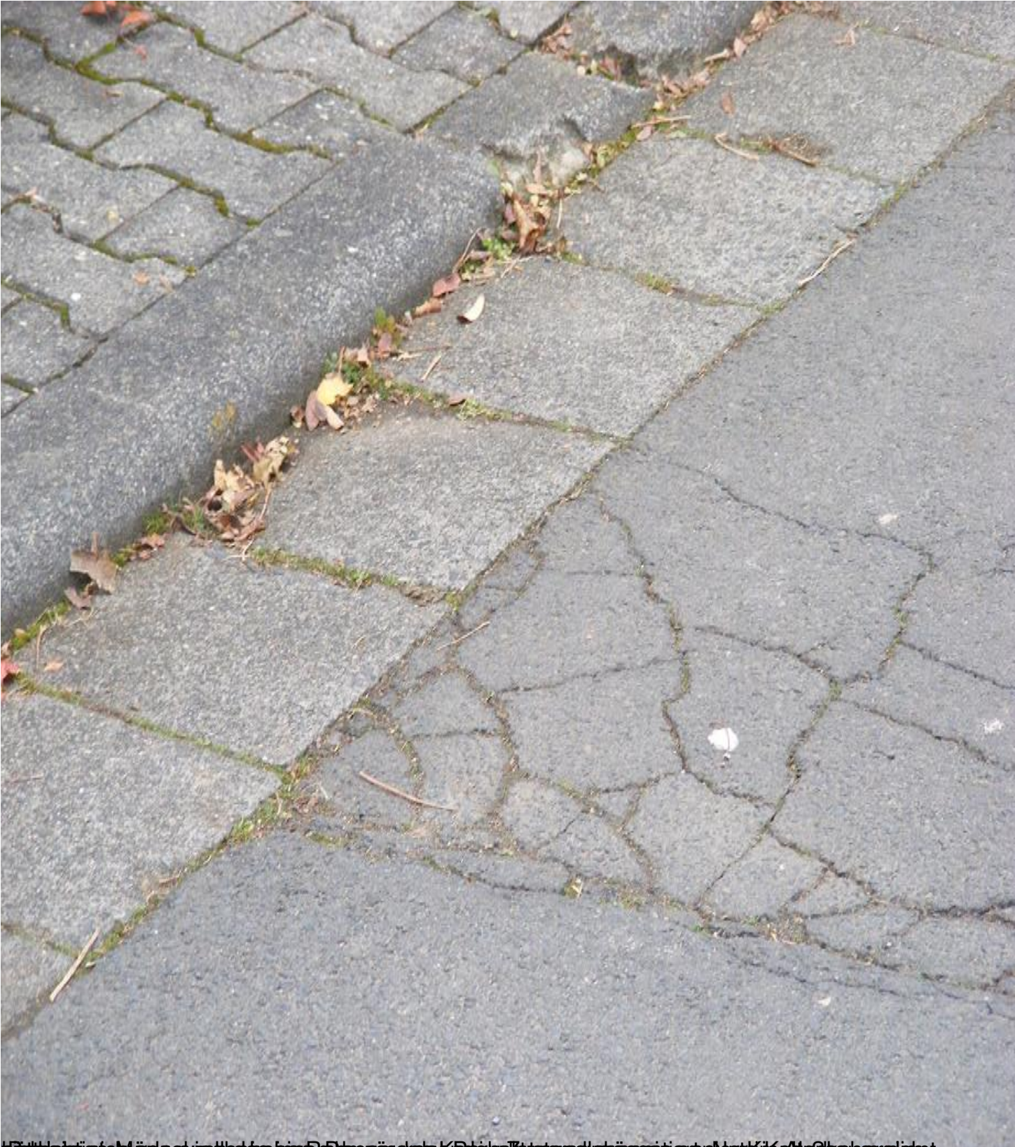
Wichtigste Mängel wie oben im Foto sind die Kluft, Kluft und die Kluft. Die Kluft ist ein Mangel, der die Sicherheit des Fußgängerverkehrs gefährdet.
