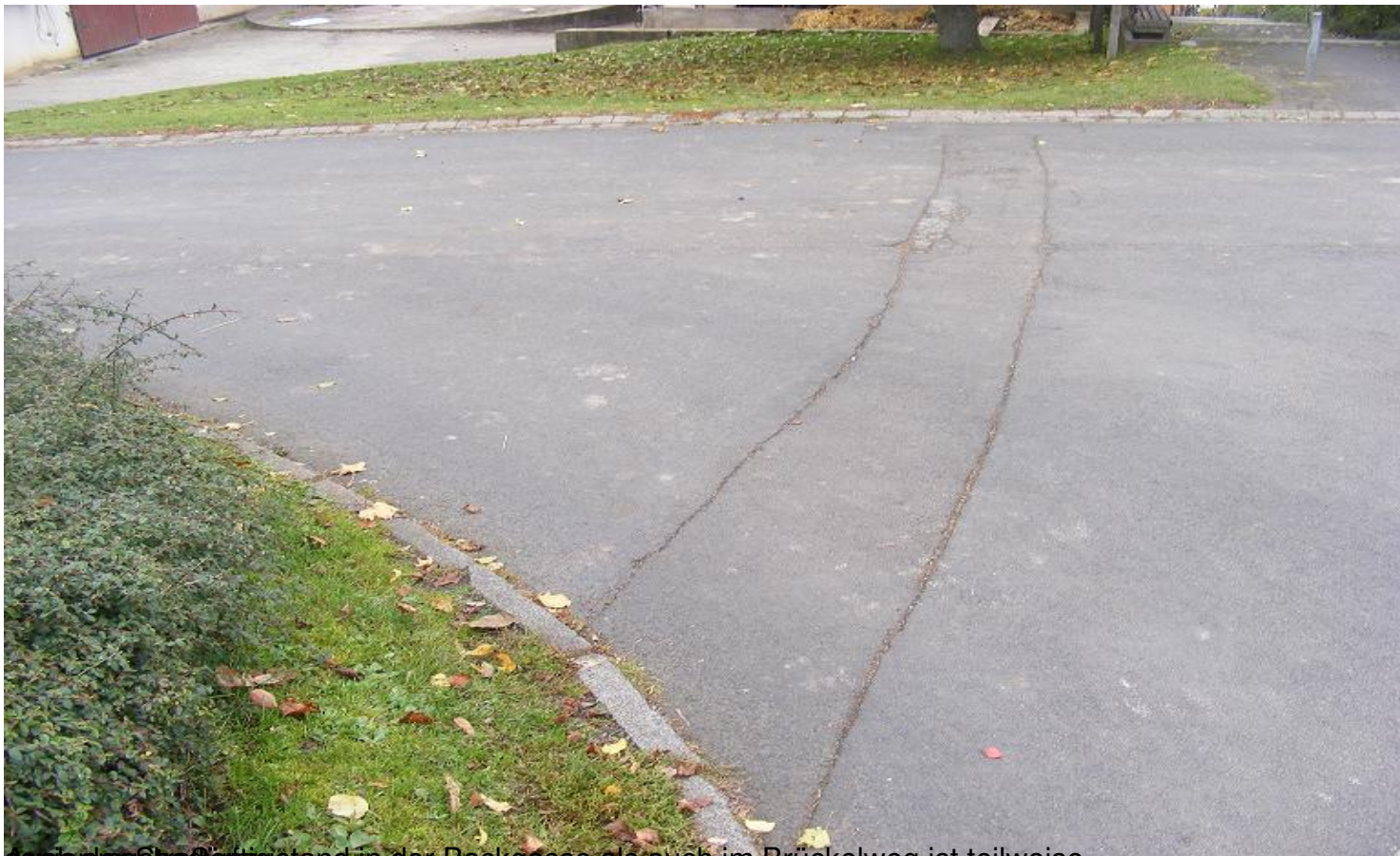
Der Straßenzustand in der Backgasse als auch im Brückelweg ist teilweise
